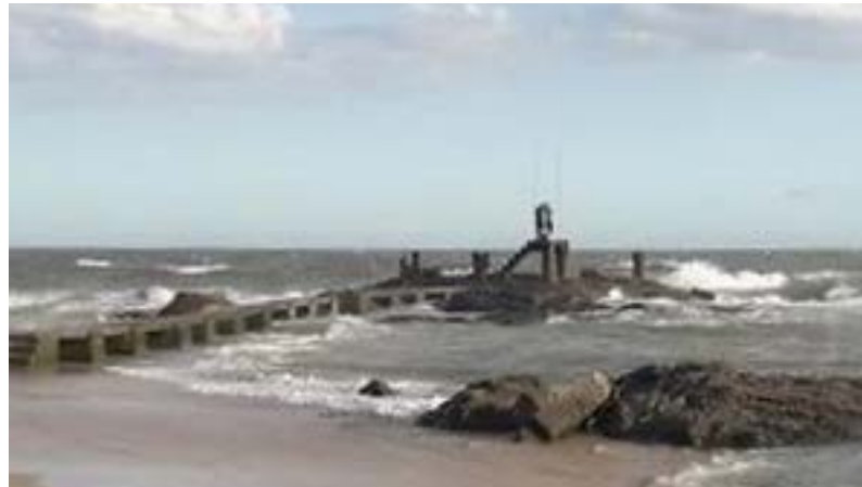
Foto actual de lo que queda del Muelle de los Pescadores
